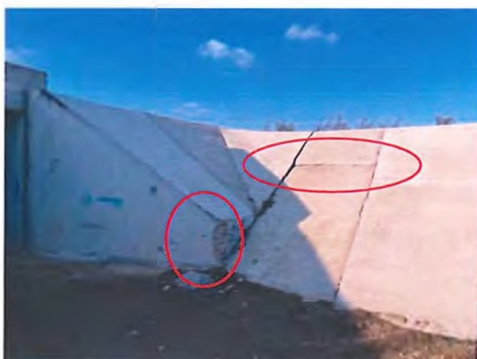
Fig. 6.5.25-8 - Degradări la aripi și pereu
